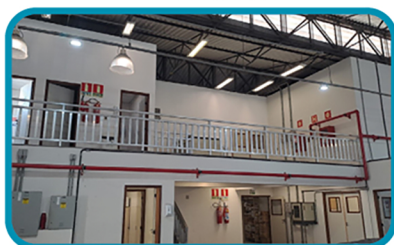
Sinalização de equipamentos e sistema de hidrantes – gráfica
