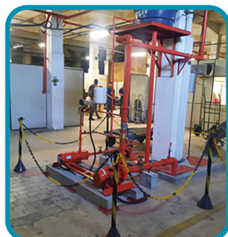
Casa de Máquinas de incêndio (CMI) sistema de hidrantes- depósito Pr. da Bandeira
