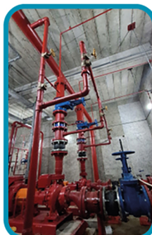
Casa de Máquinas de incêndio (CMI) sistemas de hidrantes e sprinklers – Lâmina II
