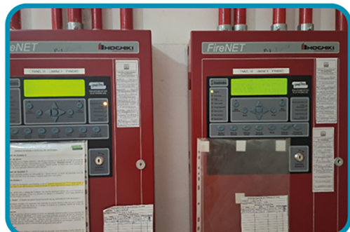
Painéis do sistema de alarme de incêndio (SDAI) – Lâmina II
