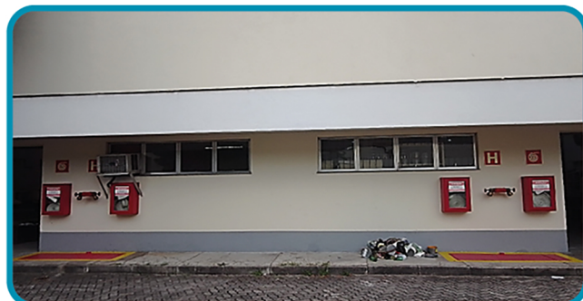
Sinalização de equipamentos e Sistema de Hidrantes – gráfica
