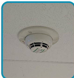
Detectores do sistema de alarme de incêndio (SDAI) – CONAB
