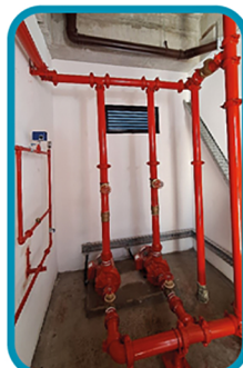
Casa de Máquinas de incêndio (CMI) – NAI
