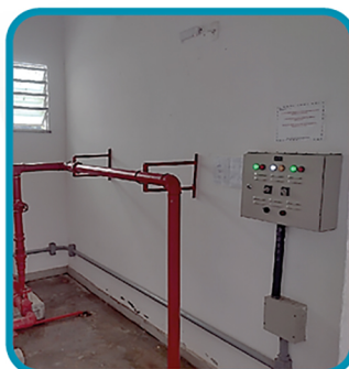
Casa de Máquinas de incêndio (CMI) sistema de hidrantes – Santo Antônio de Pádua
